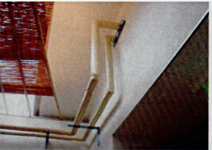
撮影項目 宿毛育成園給湯設備改修工事 室内配管保温状況
